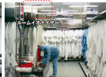
更衣室の設置例
